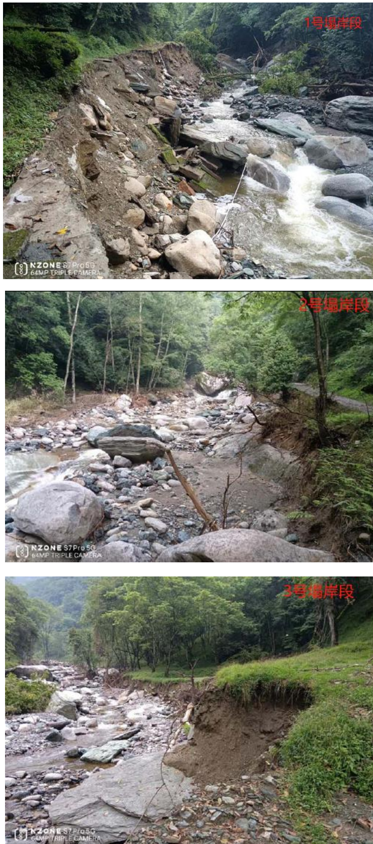
图 2.4-3 吴尔沟塌岸段现状
