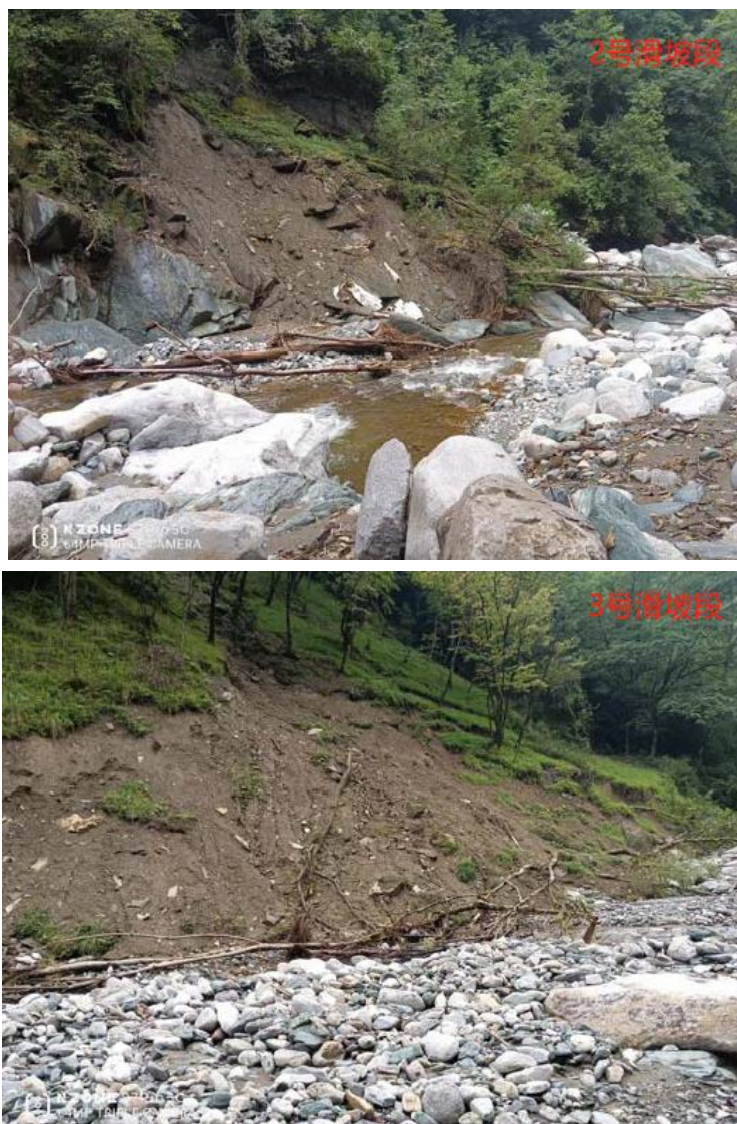
图 2.2-4 吴尔沟滑坡段现状
