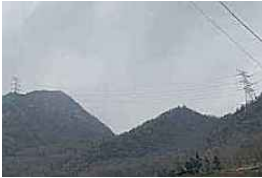
500KV 路富一二线
