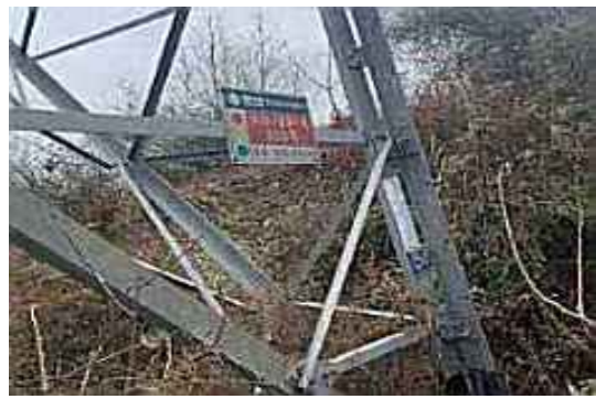
500KV 茂谭I线
