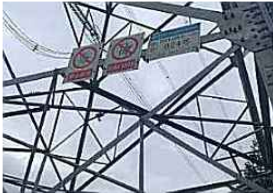
500KV 路乐一线
